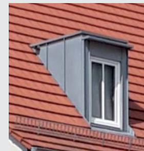
Flachdachgaube mit Zinkblech
